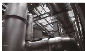
プラント配管
